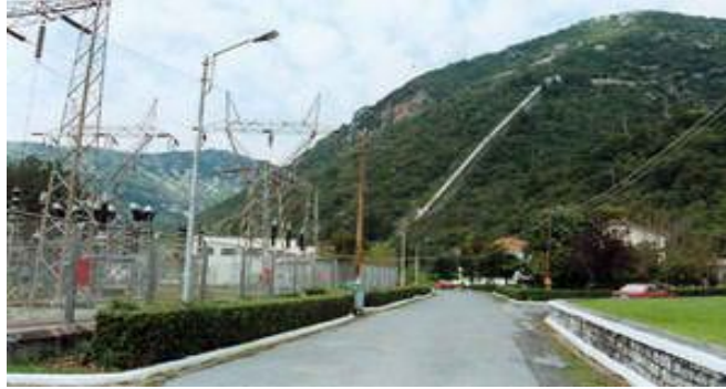
Εικ ́να 8: Εγκατάσταση εκμετάλλευσης υδατόπτωσης
