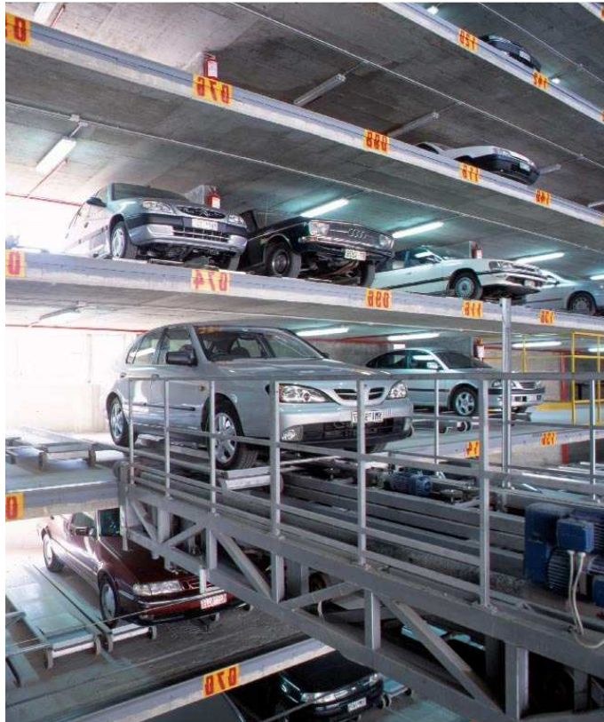
Εικόνα 9: Τρόπος τοποθέτησης του οχήματος στη θέση στάθμευσης από τον πύργο ανέλκυσης
