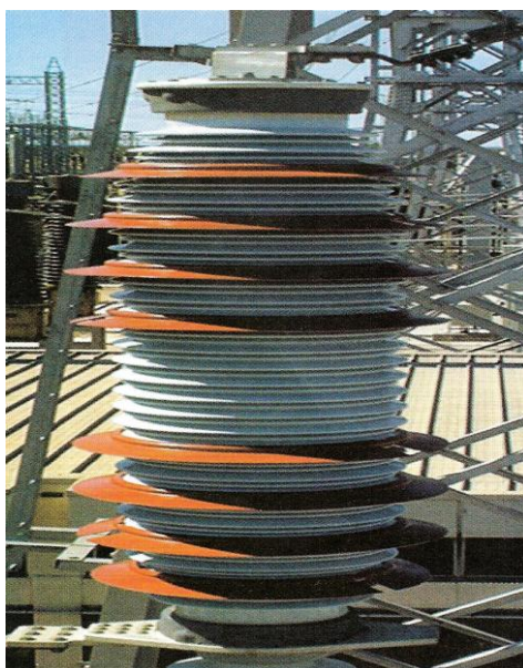
Εικόνα 2.5.1: Τοποθέτηση extenders σε μονωτήρα στηρίξεως πορσελάνης
