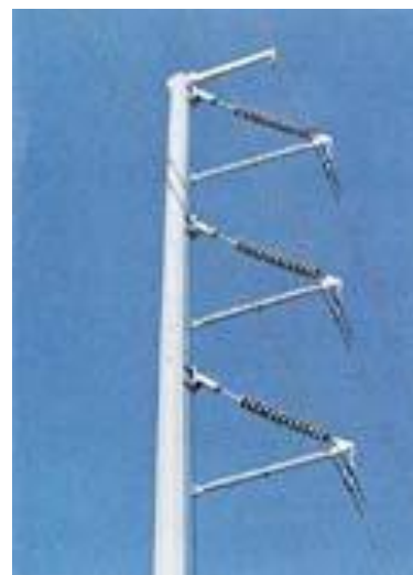
Εικόνα 1.6.5.4: Μονωτήρες τύπου line post σε γραμμή Υ.Τ.
