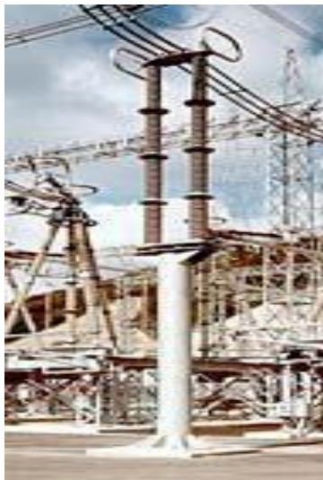
Εικόνα 1.6.5.3: Μονωτήρες τύπου station post σε υποσταθμούς
