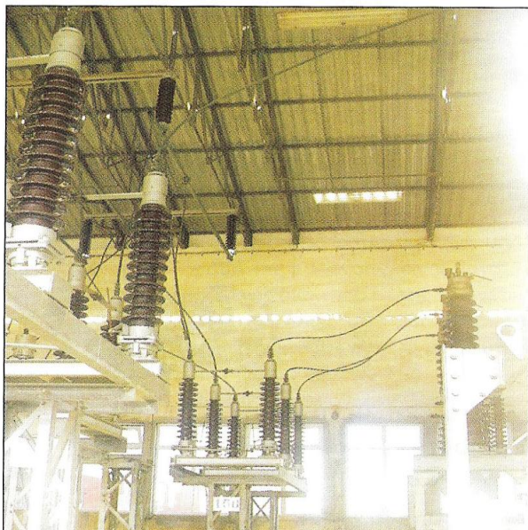
Εικόνα 2.3.1.1.1: κλειστός σταθμός 66KV με μόνωση αέρα στον Α.Η.Σ. Λινοπεραμάτων
