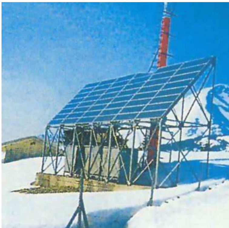
Σχήμα 1.15 Αυτόνομο φωτοβολταϊκό σύστημα τηλεπικοινωνιών στο όρος Δίρφη.
