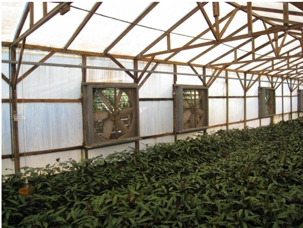
ε9: Σύστημα δροσισμού με ειδικούς εξαεριστήρες.
