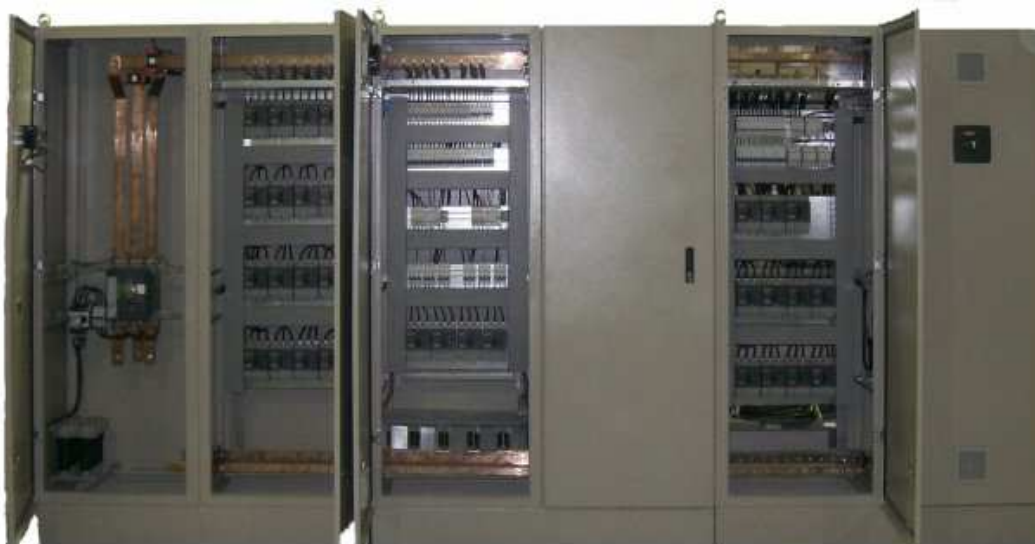
στ1: Ηλεκτρολογικός πίνακας θερμοκηπίου.
