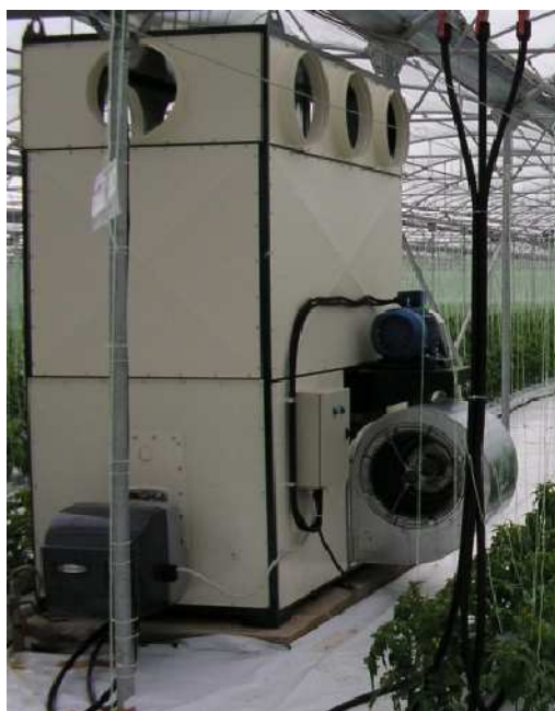
ε4:Θέρμανση με Αερόθερμο.
