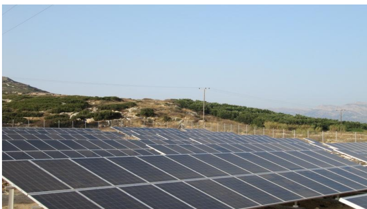
Εικόνα 3.5(Φωτοβολταϊκό πάρκο στο Σαγκρί της Νάξου, εικόνα από προσωπική έρευνα)
