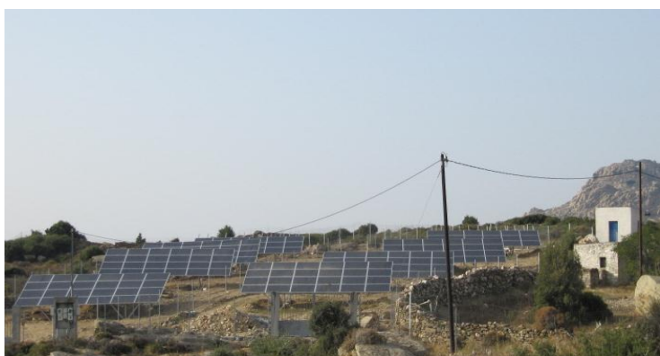
Εικόνα 3.4 (Φωτοβολταϊκά πάρκα στο Δαμαλά της Νάξου, εικόνα από προσωπική έρευνα)
