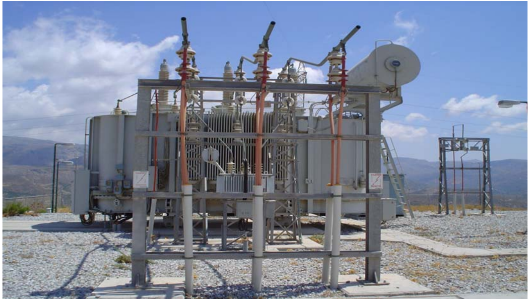
Εικ. 4.3 Μετασχηματιστής υψηλής τάσης Μαρωνιάς.
