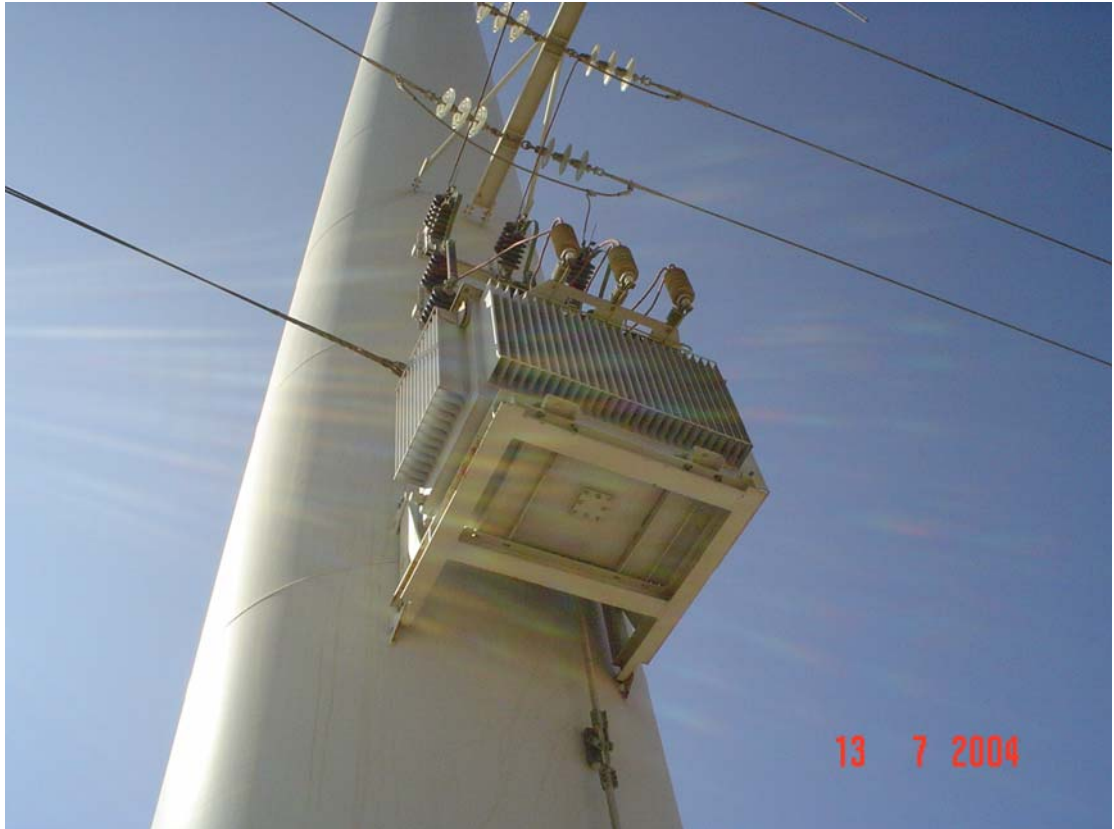
Εικ.4.2 Μετασχηματιστής ανύψωσης τάσης.(Αιολικό πάρκο Αχλαδίων).
