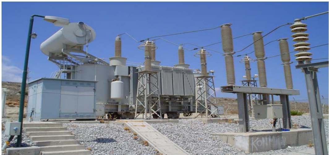
Εικ. 4.4 Μετασχηματιστής υψηλής τάσης Μαρωνιάς.
