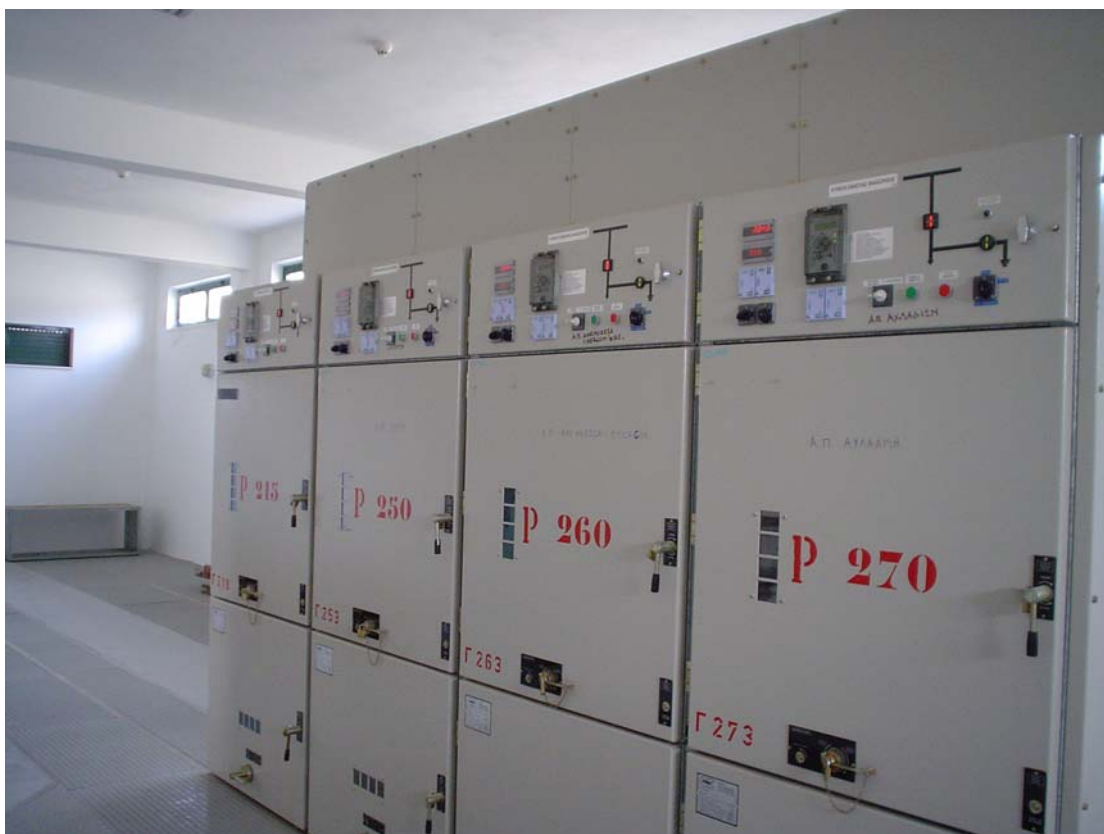
Εικ.4.1 Διακόπτες Μέσης Τάσης.(Υποσταθμός Μαριωνιάς).
