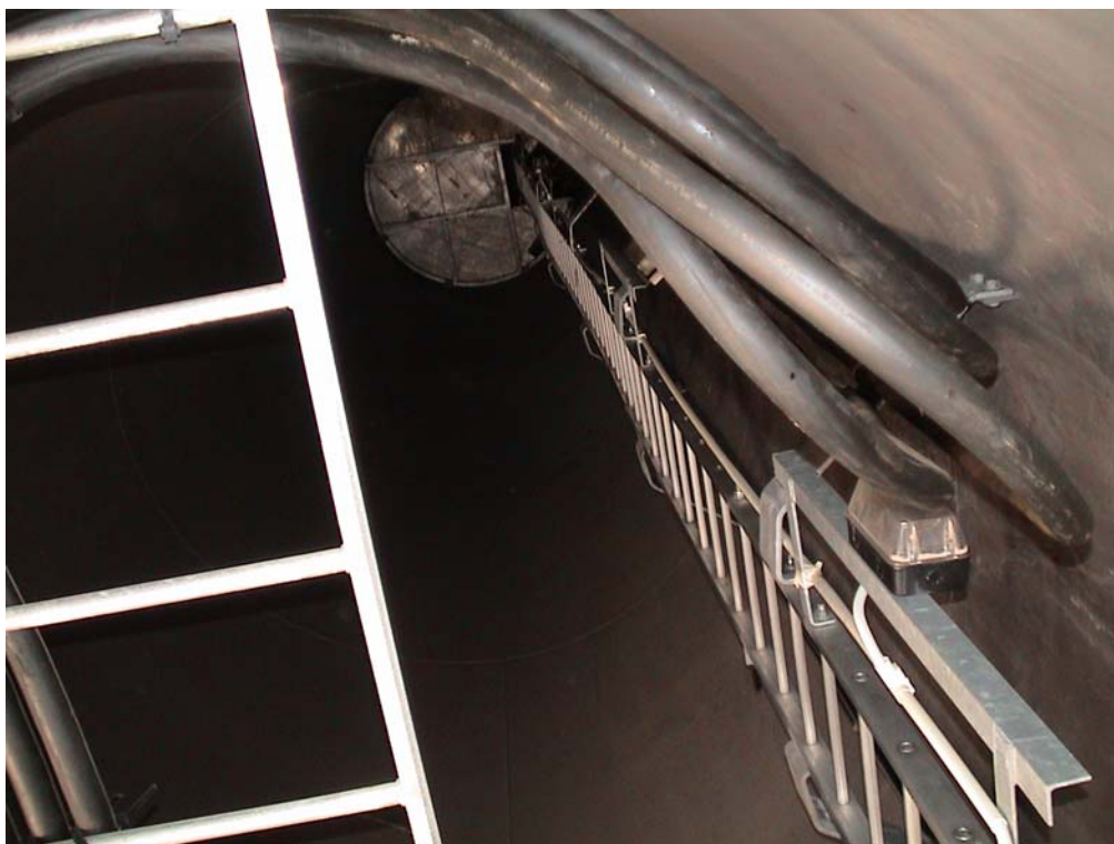
Εικ. 3.1 Καλώδια ισχύος.
