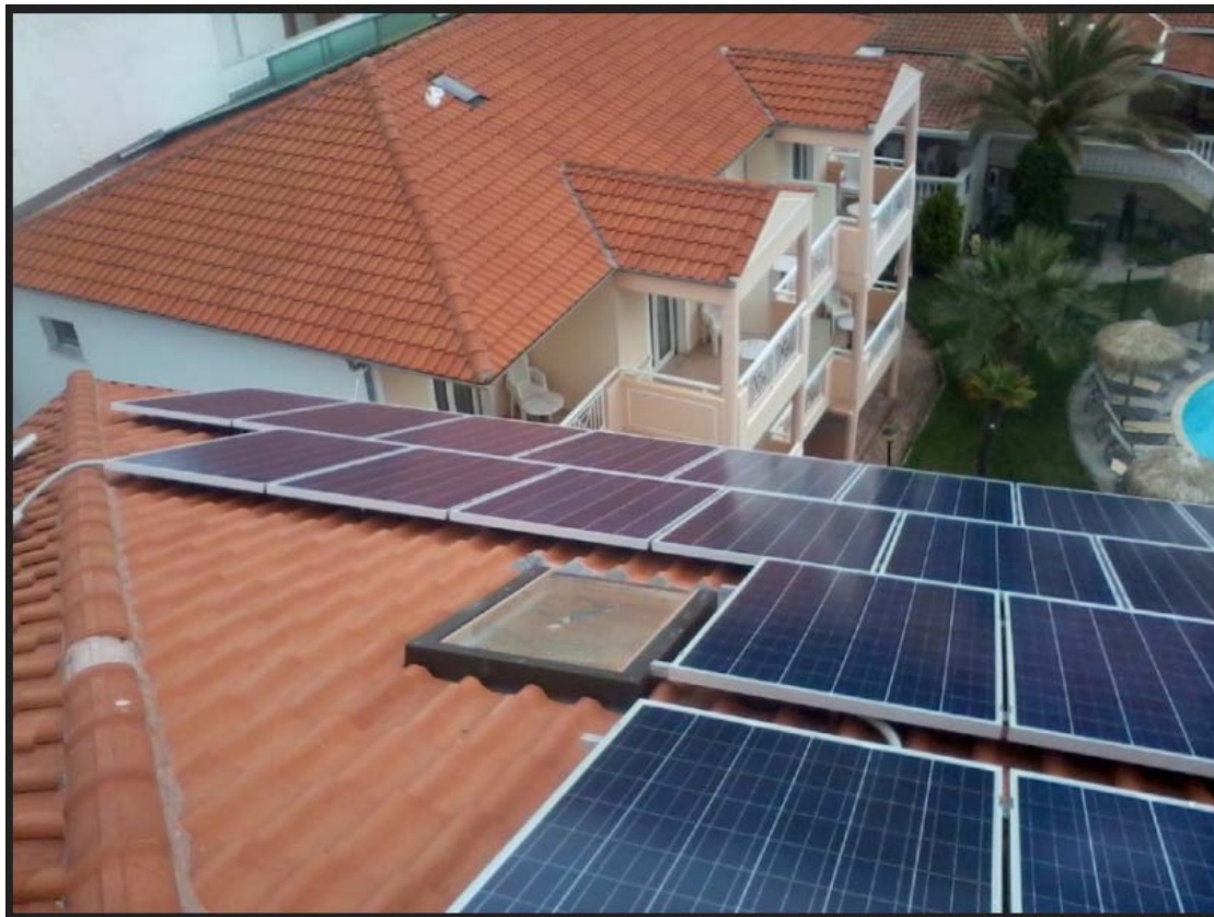
Εικόνα 3 "Φωτοβολταϊκή Συστοιχία σε Στέγη"
