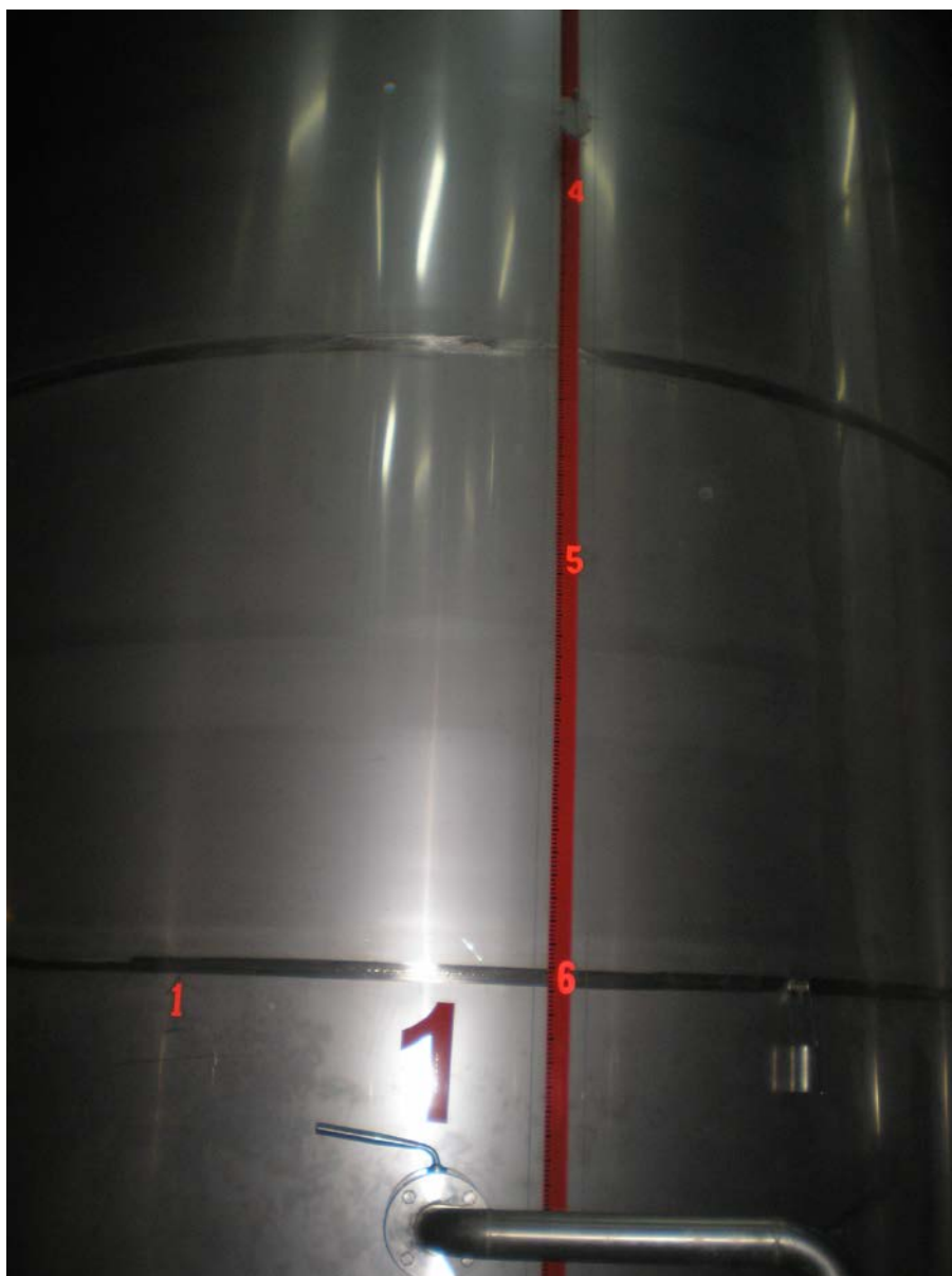
Εικόνα 34 δεξαμενή που αποθηκεύουν το λάδι
