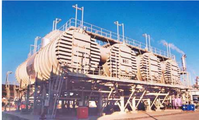
Εικόνα 1.6 Μονάδα πολυβάθμιας εξάτμισης στα Ηνωμένα Εμιράτα (Eta Power Projects Division 2007)
