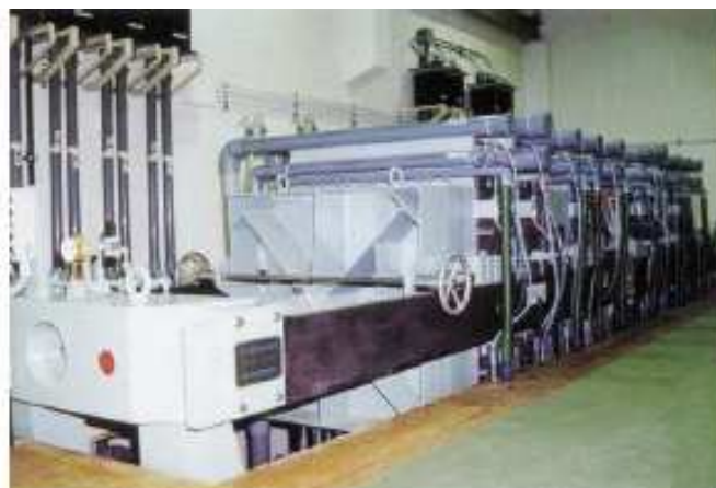
Εικόνα 1.11 Μονάδα ηλεκτροδιάλυσης στην Ιαπωνία (Astom Corporation 2004)
