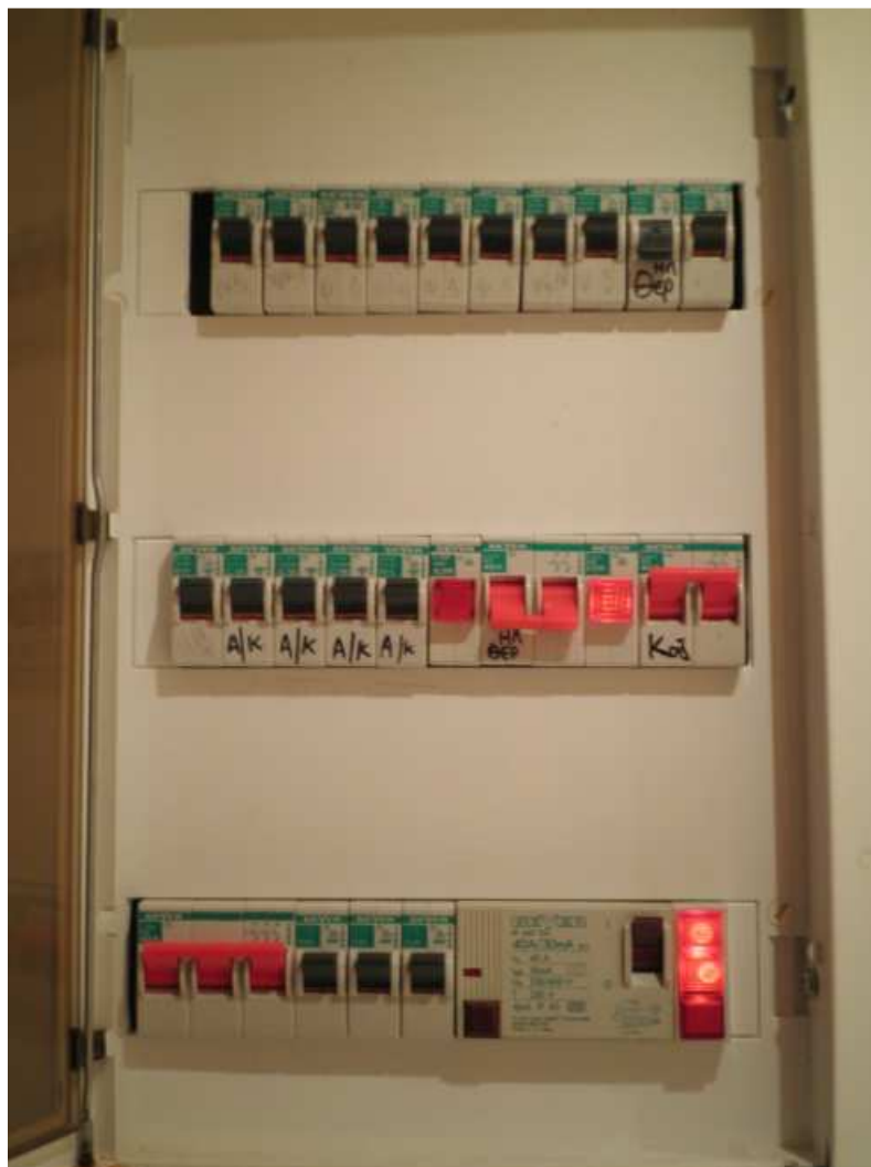
Εικόνα 1.3: Ηλεκτρικός πίνακας υπό μελέτη οικίας
