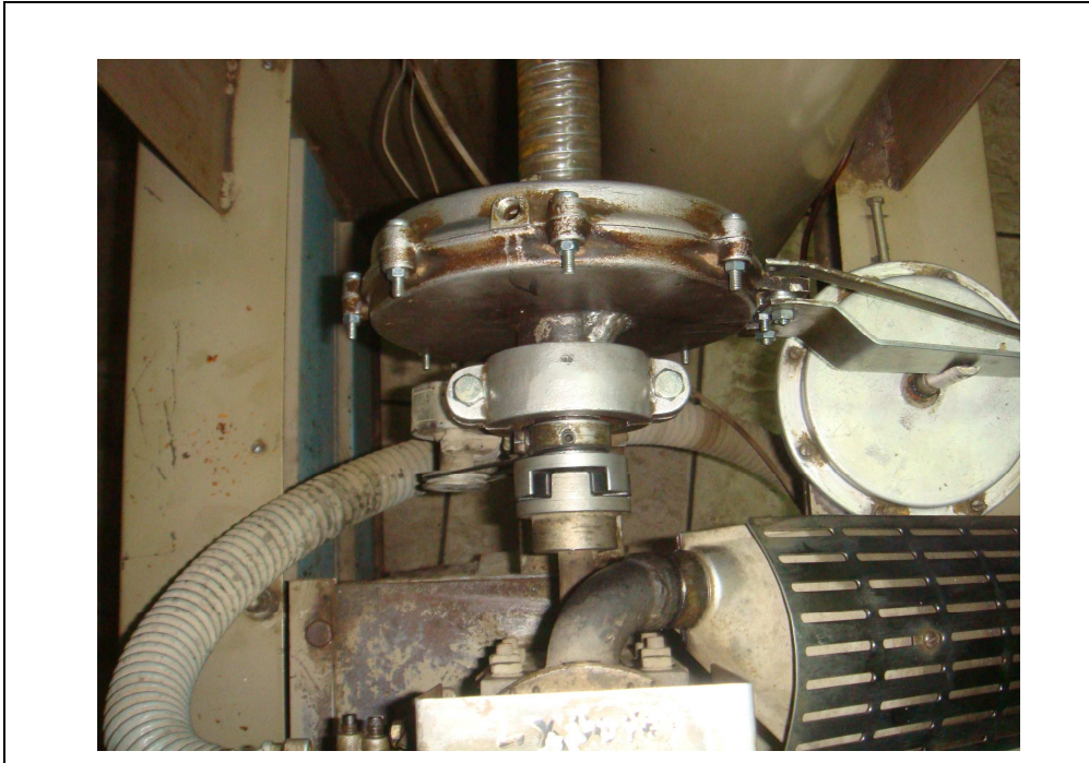
Η πέδη τοποθετημένη πάνω στην βάση
