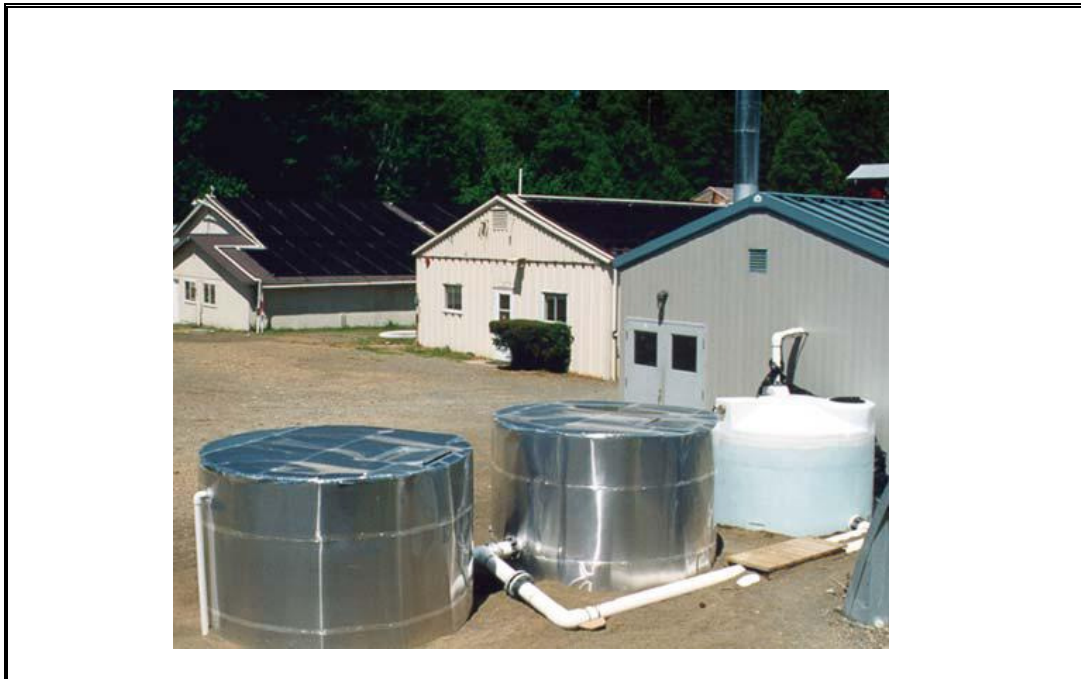
Εικόνα 5. Ηλιακό σύστημα θέρμανσης νερού σε εκκολαπτήριο σολομών
