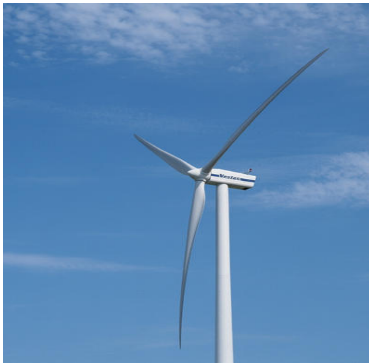
Εικόνα 4.2: Ο δρομέας της ανεμογεννήτριας Vestas V90 / 3 MW.
