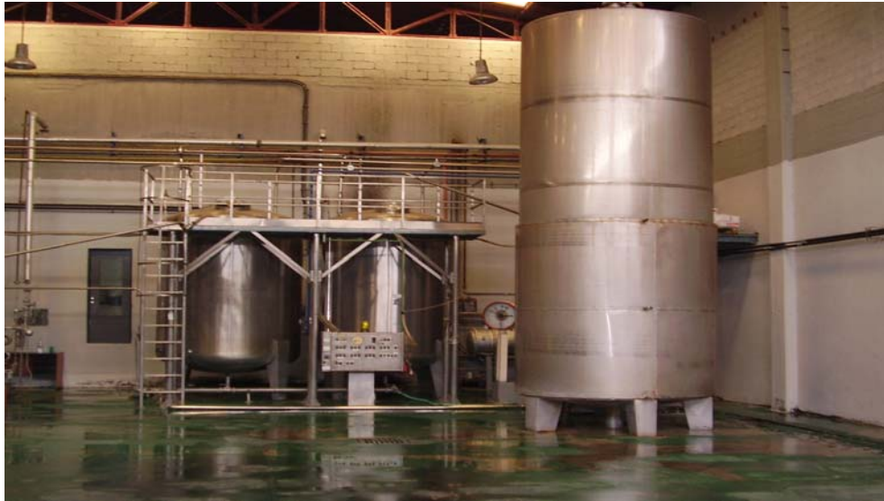
Εικόνα 3. Μονάδα παρασκευής σιροπιών
