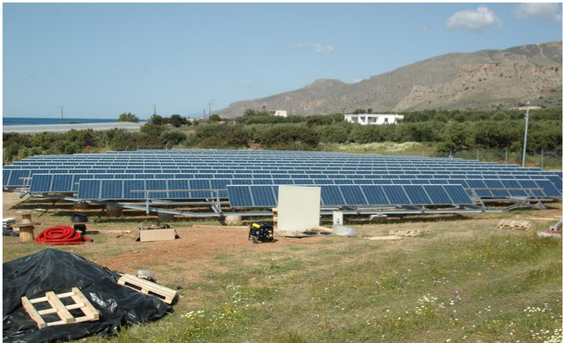
Εικ.2. Φωτοβολταϊκός σταθμός ΓΟΥΔΟΥΡΑΣ
