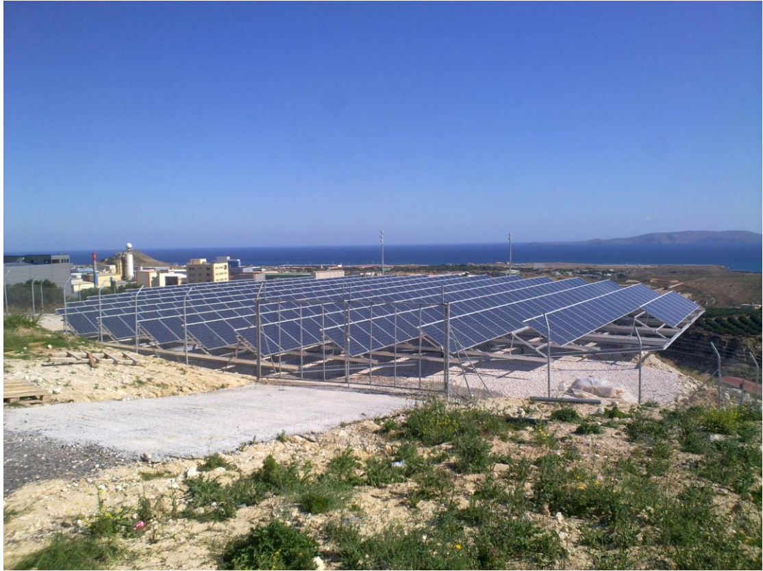
Εικ.1. Φωτοβολταϊκός σταθμός ΒΙΠΕ.Η.
