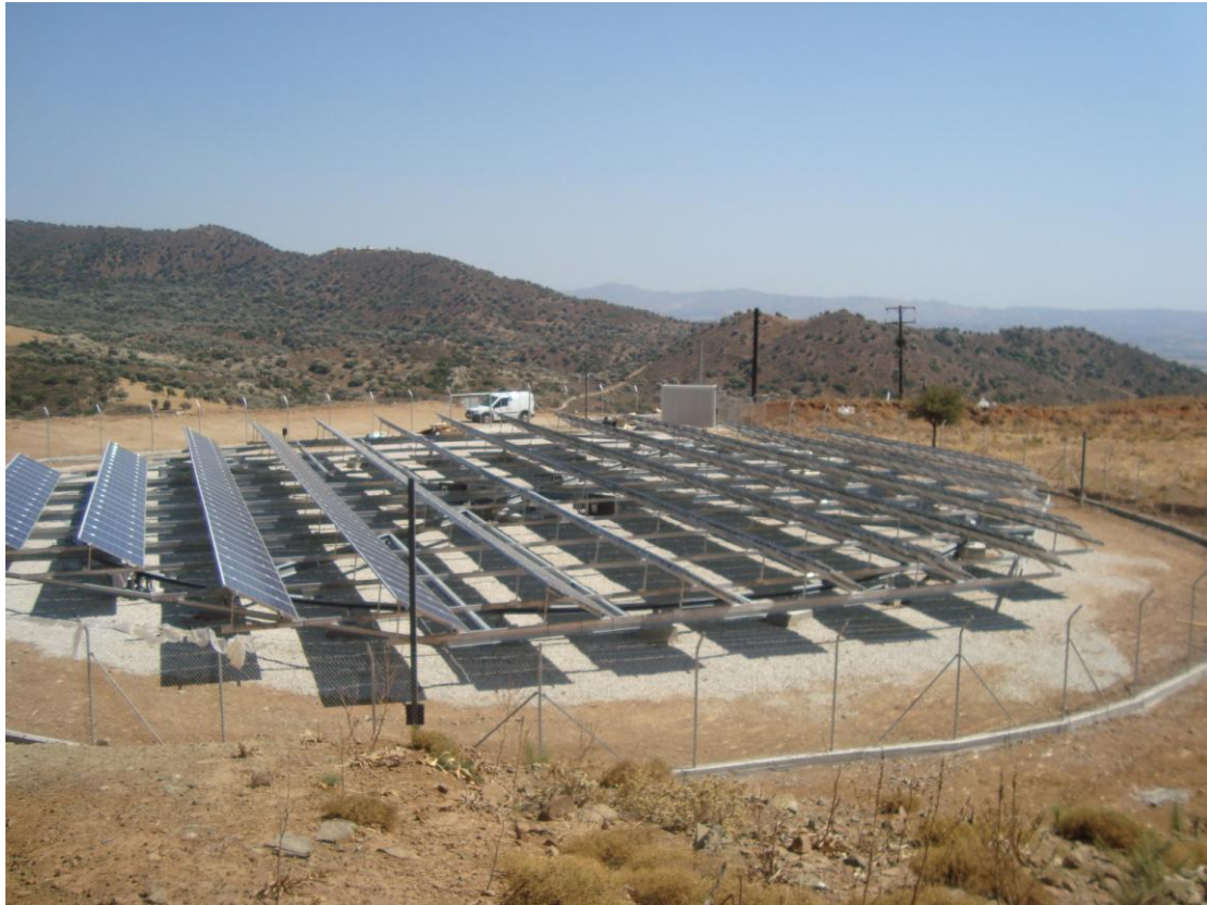
Εικ.3.Φωτοβολταϊκός σταθμός ΓΟΥΔΟΥΡΑΣ
