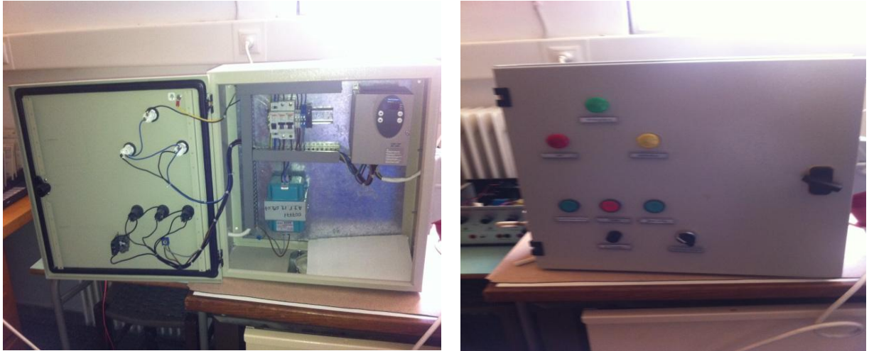
σχ.4.4 : Εσωτερική και εξωτερική άποψη Inverter
