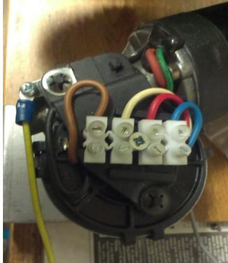
Εικόνα 37: Γείωση προστασίας και κλέμα καλωδίων 4 θέσεων
