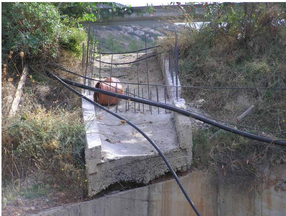
Φώτο 3.14 Τεχνικό φρεάτιο απορροής υδάτων Εθνικής Οδού
