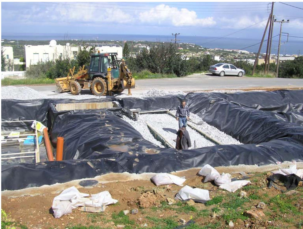
Φώτο 3.27 Πλήρωση δεξαμενών με μηχανικό εκσκαφέα και διάστρωση υλικών με εργατικό προσωπικό
