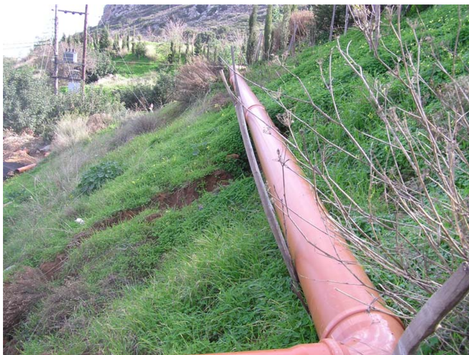
Φώτο 3.15 Σωλήνας εισροής υδάτων από φρεάτιο Εθνικής Οδού προς δεξαμενή προσωρινής αποθήκευσης
