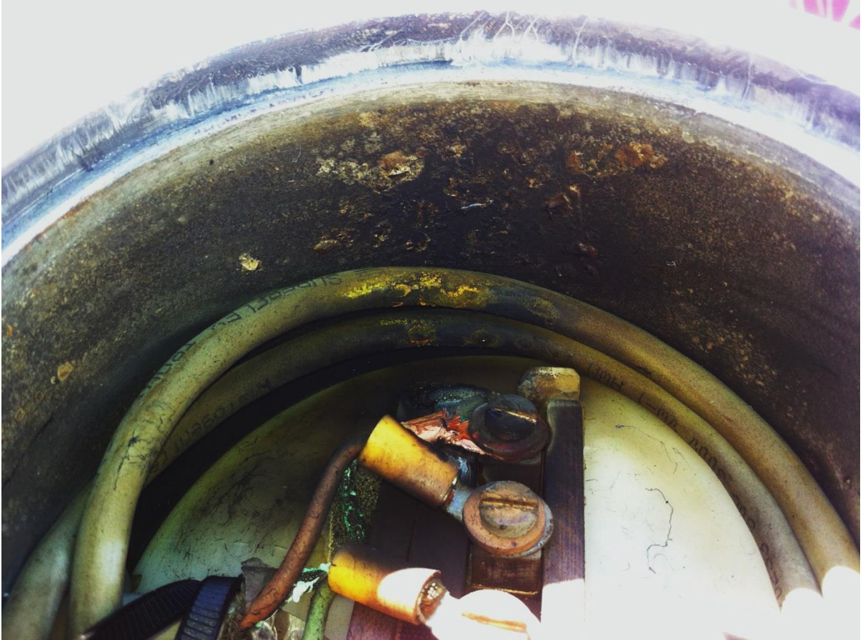
Εικόνα 19 : Βραχυκύκλωμα στις ενώσεις των καλωδίων με τις ψήκτρες μετά από 9 μήνες λειτουργίας. Τα πράσινα κατάλοιπα από την φλόγα καταδεικνύουν την ύπαρξη υγρασίας από θαλασσινό νερό. Αιτία της βλάβης ήταν η λαθεμένη θέση των καλωδίων και η μη επαρκής σύσφιξη των βιδών σε συνδυασμό με την ύπαρξη αλμύρας.
