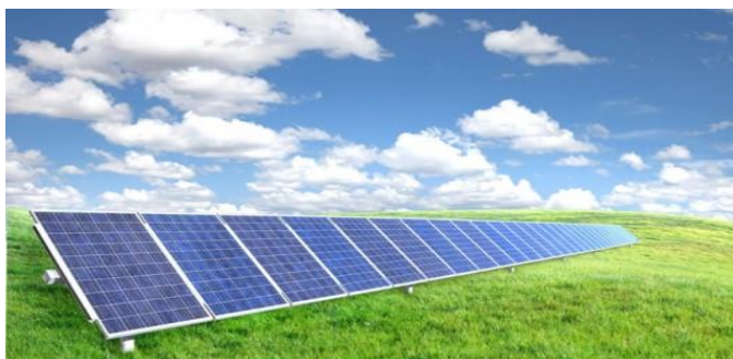
Σχήμα 6.6 : Φωτοβολταϊκό σύστημα περοβσκήτη
