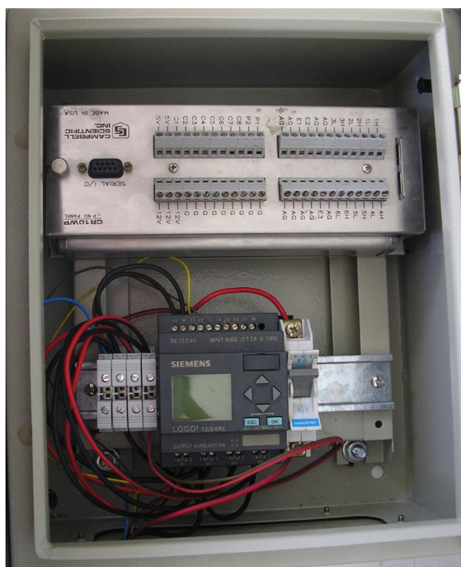
Εικόνα 35 Ο ηλεκτρολογικός πίνακας όπου βρίσκονται η συσκευή καταγραφής δεδομένων και ο προγραμματιζόμενος λογικός ελεγκτής. Ο πίνακας είναι καλά μονωμένος για την προστασία από την υγρασία των συσκευών και των συνδέσεων.
