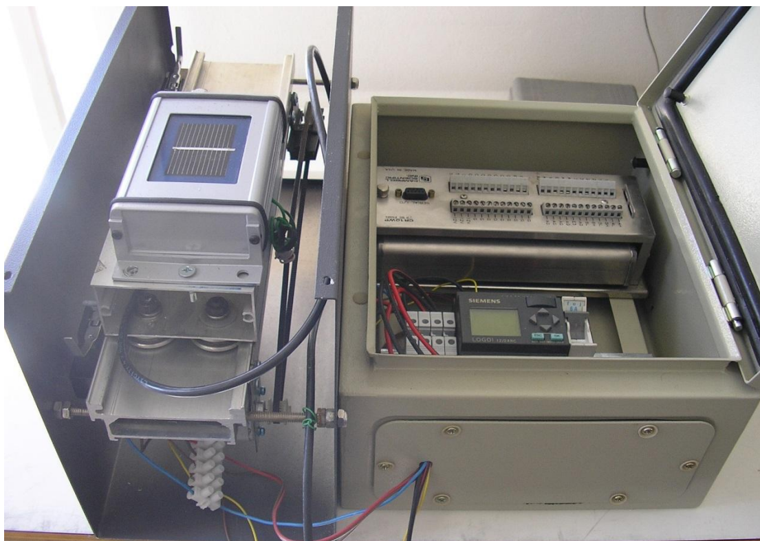
Εικόνα 32 Αριστερά ο μηχανισμός κίνησης του φωτοβολταϊκού στοιχείου και δεξιά η συσκευή καταγραφής μαζί με τον προγραμματιζόμενο λογικό ελεγκτή.
