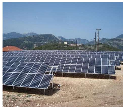
Εικ. 1.2 Φωτοβολταϊκό Πάρκο
