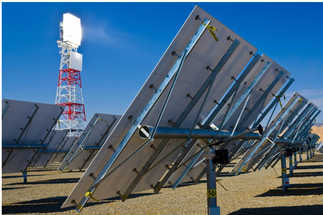
Εικόνα 3.4 Σύστημα Στήριξης Ηλιοστάτη Brightsource [30]
