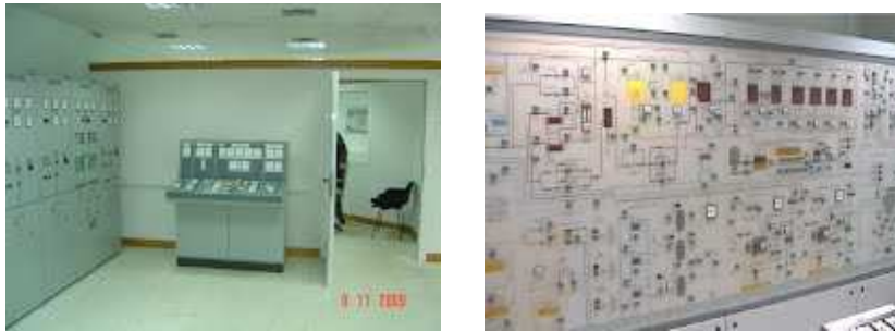
Εικόνα 20: Κονσόλα Ελάγχου (αριστερά) και mimic panels (δεξιά)
