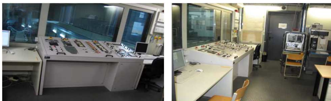
Εικόνα 15: Το δωμάτιο ελέγχου (control room) της κλίνης δοκιμών
