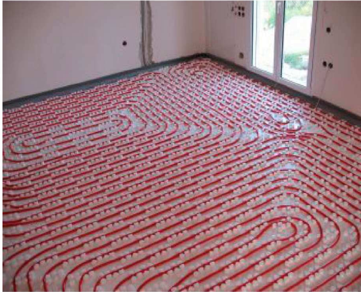
Σχήμα 2.3.7β: Φωτογραφία δωματίου μιας κατοικίας, όπου φαίνεται η τοποθέτηση των σωληνώσεων της ενδοδαπέδιας θέρμανσης
