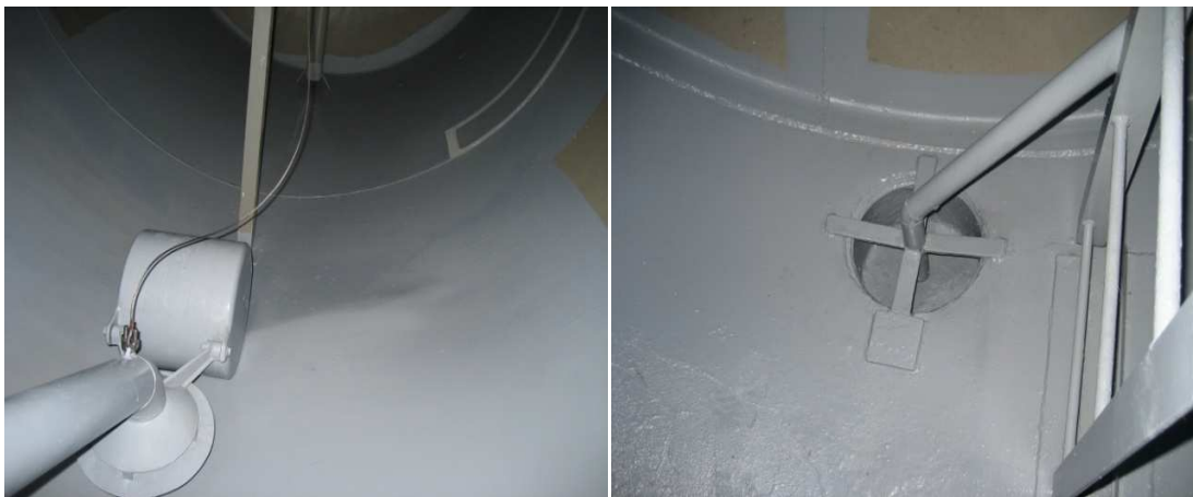
Σχήμα 16. Η δεξαμενή εσωτερικά. Αριστερά διακρίνεται η πλωτή αναρρόφηση με το συρματόσχοινο ελέγχου και στο βάθος η σωλήνα πλήρωσης. Δεξιά το σημείο της αποστράγγισης με την σκάλα εισόδου – εξόδου της δεξαμενής
