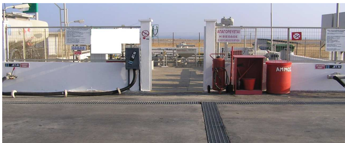
Σχήμα 27. Διακρίνονται τα μέσα πυροπροστασίας σε μια εγκατάσταση
