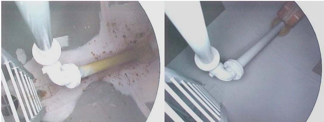
Σχήμα 31. Δεξαμενή από ανθρωποθυρίδα. Αριστερά η δεξαμενή όταν ανοίχτηκε. Δεξιά το ίδιο σημείο μετά τον καθαρισμό
