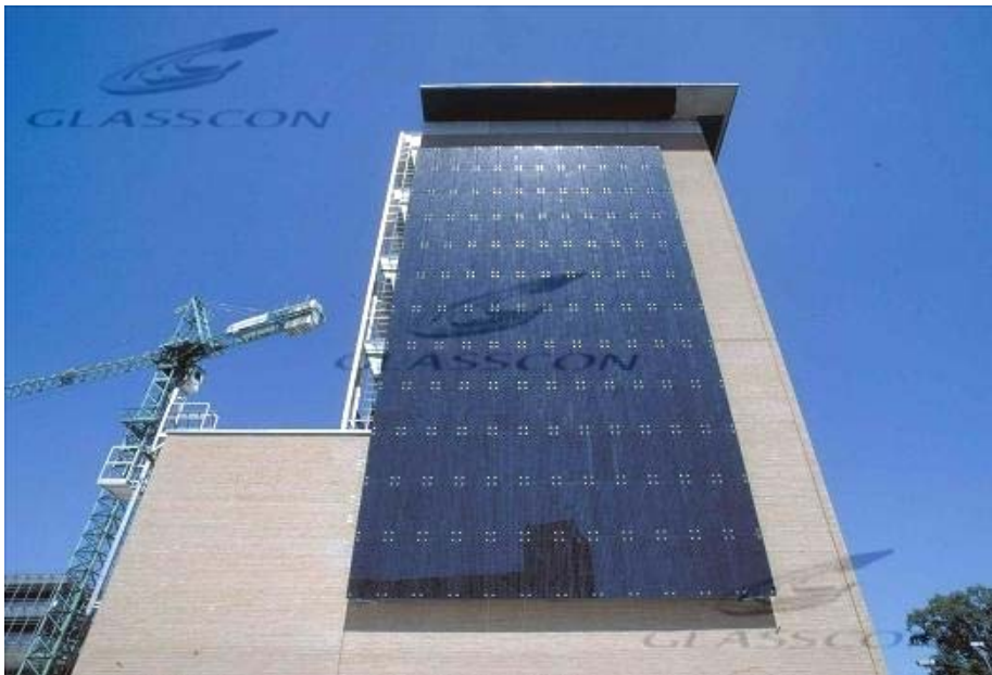
Εικ 4.12 Τοποθέτηση Φ/Β παράλληλα στην πρόσοψη πολυόροφου κτηρίου
