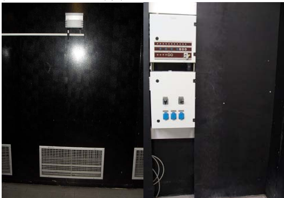
1.Όψη του θαλάμου (σένσορας και αεραγωγού)
