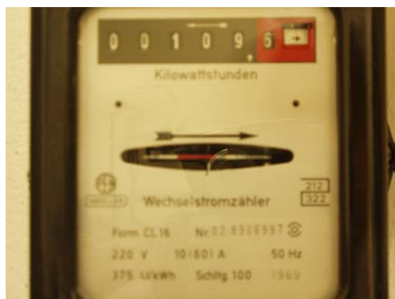
Εικόνα. 11.1 Μετρητής ΗΛ. Ενέργειας
