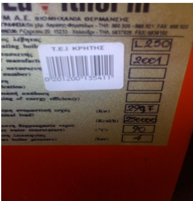
Εικόνα 2.3: Λέβητας Συστήματος Θέρμανσης
