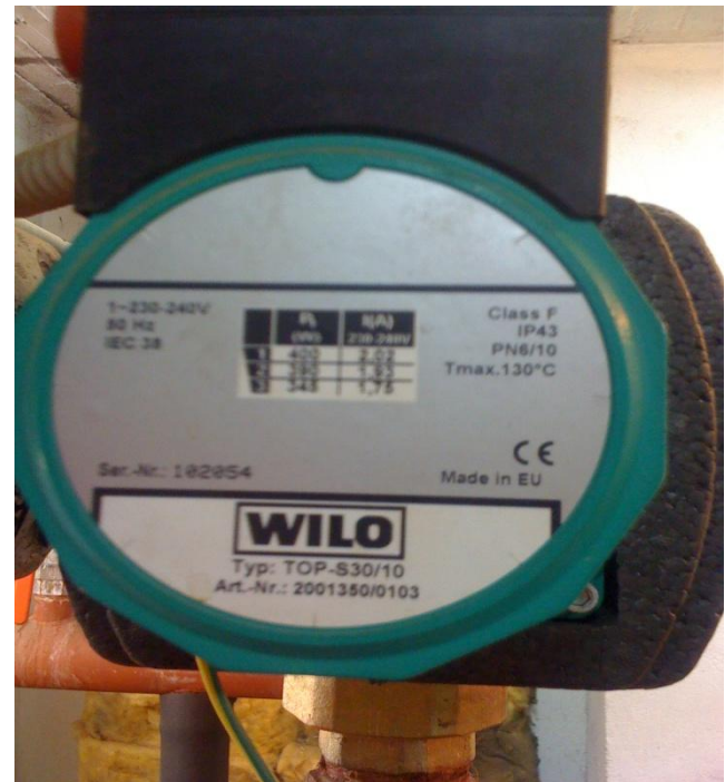
Εικόνα 2.4: Κυκλοφορητής Συστήματος Θέρμανσης
