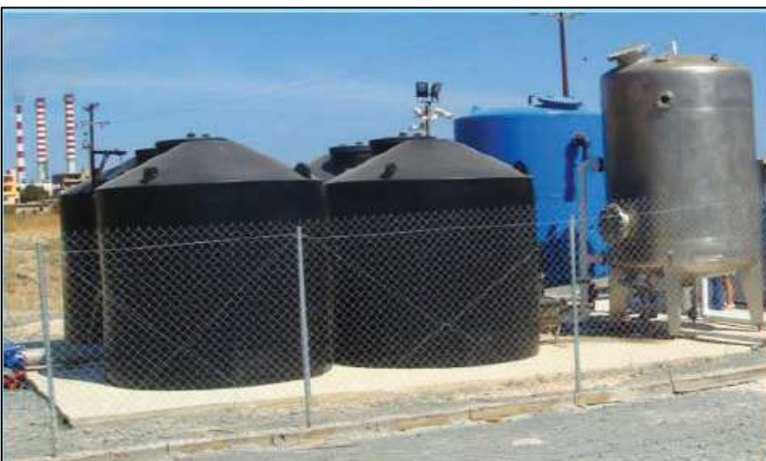
Εικόνα 55 : Δεξαμενές προσωρινής αποθήκευσης ακατέργαστου νερού
