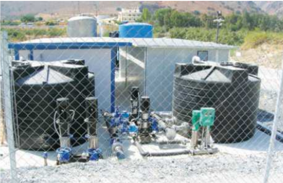
Εικόνα 56 : δεξαμενές προσωρινής αποθήκευσης παραγόμενου νερού και απορριπτόμενης άλμης
