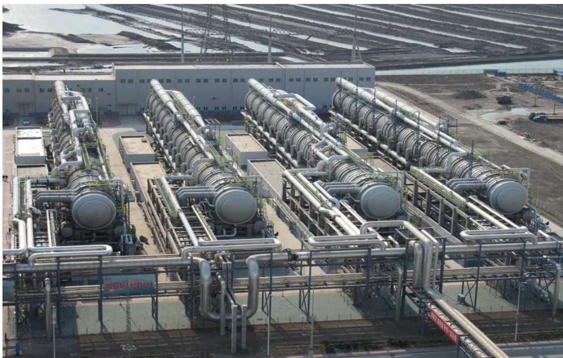
Εικόνα 8 : Εγκατάσταση πολυβάθμιας εξάτμισης στη Κίνα
