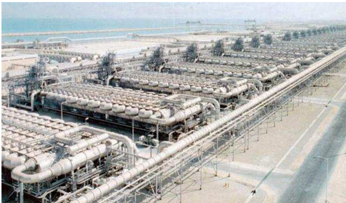
Εικόνα 9: Εγκατάσταση πολυβάθμιας εκτόνωσης στη Σαουδική Αραβία
