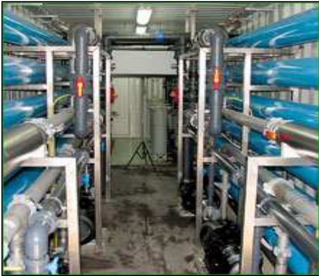
Εικόνα 45 : Άποψη από το εσωτερικό της μονάδας αφαλάτωσης
