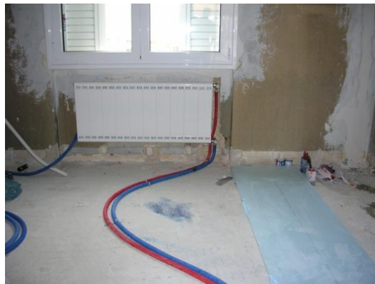
Εικ. 7.9: Εγκατάσταση καλοριφέρ κάτω από παράθυρο.
