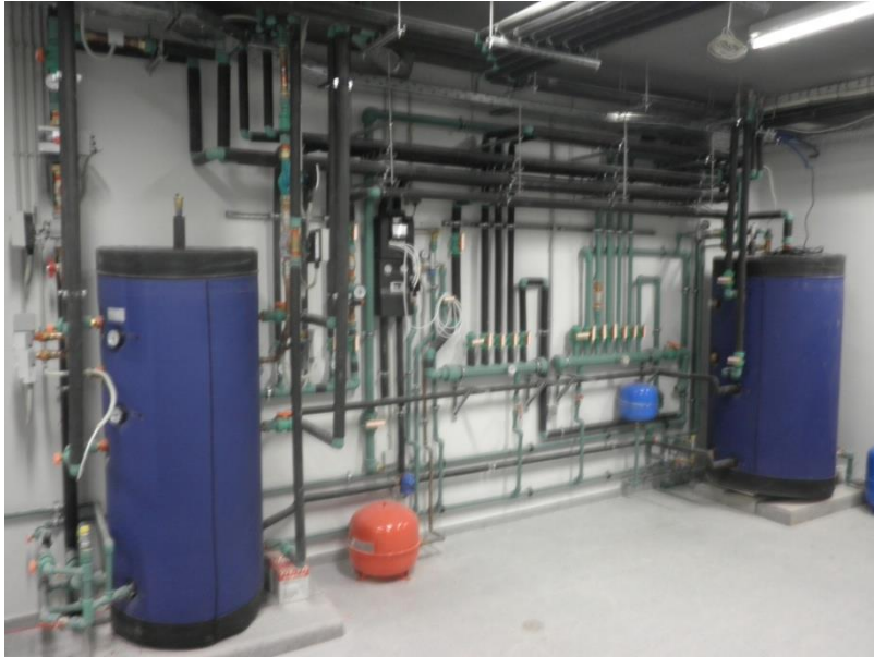
Εικ. 2.8: Εγκατάσταση δοχείων αδρανείας με αντλία θερμότητας.
