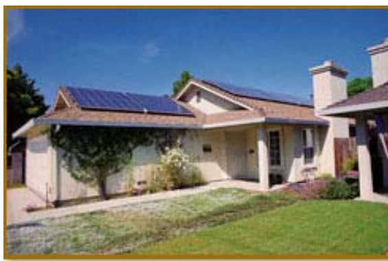
Εικόνα 6. ΦΒ στη σκεπή κτιρίου.
