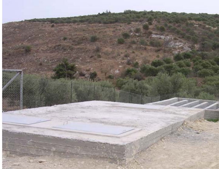
Εικόνα 13. Δεξαμενή αποθήκευσης εκροής
