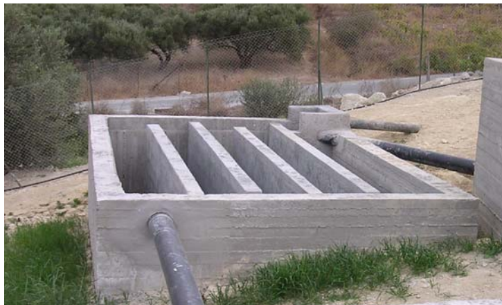
Εικόνα 12. Δεξαμενή χλωρίωσης μαιανδρικής ροής
