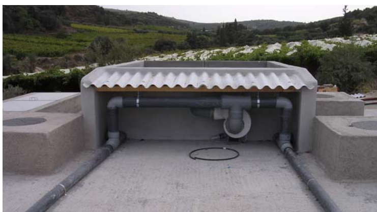
Εικόνα 6. Μονάδα εξουδετέρωσης οσμαερίων
