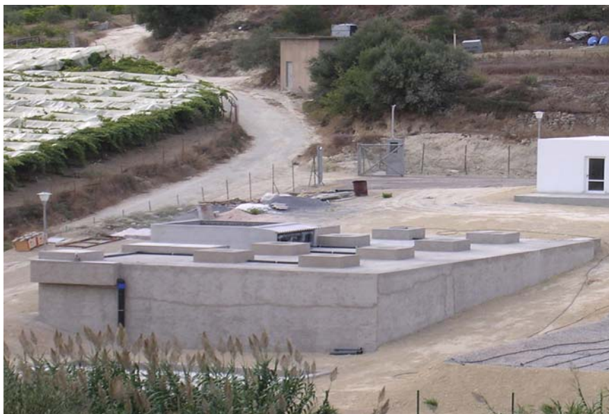
Εικόνα 4. Όψη της σηπτικής δεξαμενής και τμήματος του βιολογικού αμμοφίλτρου
