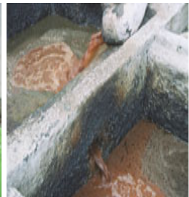
Εικόνα 1.6 Δεξαμενή επεξεργασίας Υ.Α.Ε.
