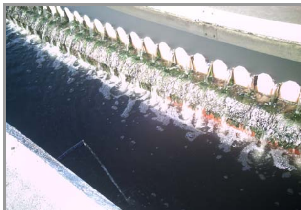
Εικόνα3.1 Δεξαμενή χλωρίωσης Βιολογικού καθαρισμού Ηρακλείου
