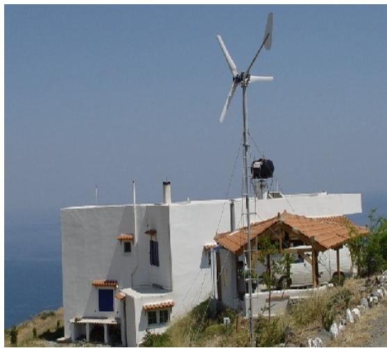
Σχήμα 3. Εγκατάσταση ανεμογεννήτριας σε οικία
