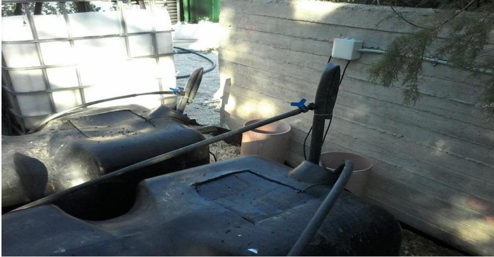
Εικόνα 19. Δεξαμενή αποθήκευσης με αντλία
