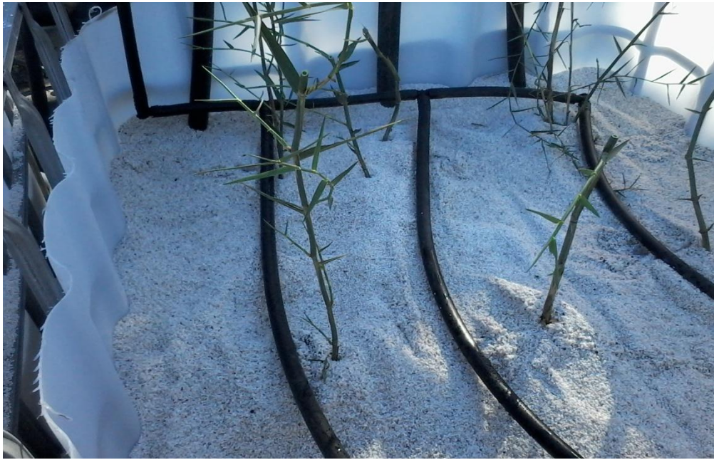
Εικόνα 20. Διάτρητοι σωλήνες διανομής των λυμάτων στον υδροβιότοπο
