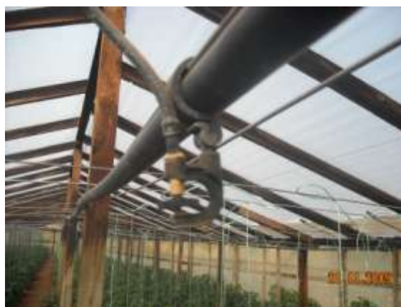
Εικόνα 23: Μπέκ ποτίσματος σε αγωγό που βρίσκεται στην οροφή του θερμοκηπίου.
