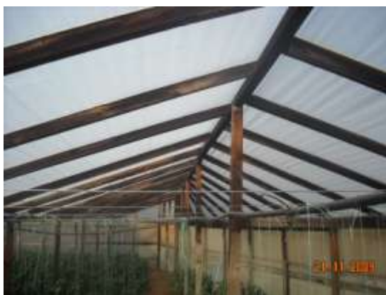
Εικόνα 7: Ξύλινος σκελετός θερμοκηπίου στην Κουντούρα. Παρακάτω παρατίθενται δύο πίνακες που δείχνουν τη διάρκεια ζωής διαφόρων ειδών ξύλου( εγκάρδιο ξύλο):
