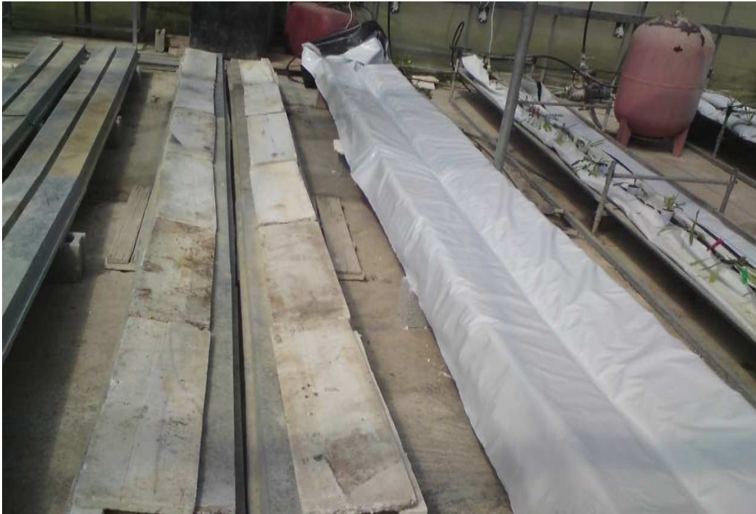
Εικόνα 3.2. Προετοιμασία των καναλιών. Τοποθέτηση λαμαρινών (αριστερά), τοποθέτηση τμημάτων φελιζόλ για μόνωση και την επίτευξη κατάλληλης κλίσεως –προς το εσωτερικών των καναλιών (μέση) και εφαρμογή διπλής όψεως νάιλον για την τοποθέτηση των σάκων (δεξιά).
