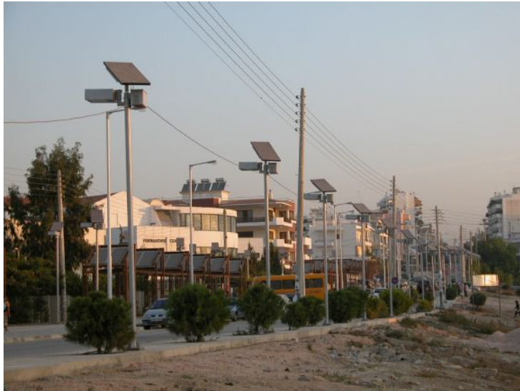
Εικόνα 24: Αυτόνομα φωτοβολταϊκά φωτιστικά δρόμου | Δήμος Αλίμου [Πηγή: 16]
