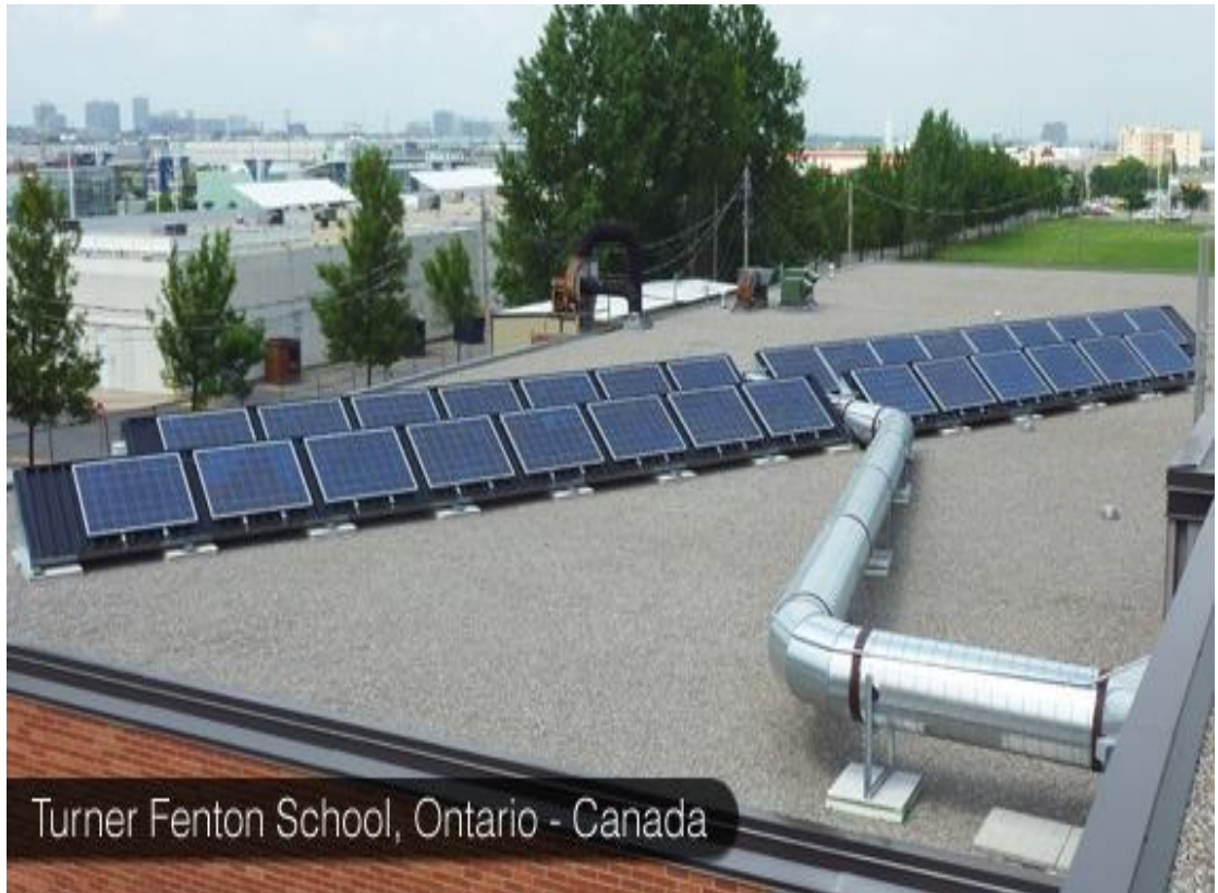
(Εικόνα 22) Εγκατάσταση PV/T με αέρα σε ταράτσα κτηρίου
