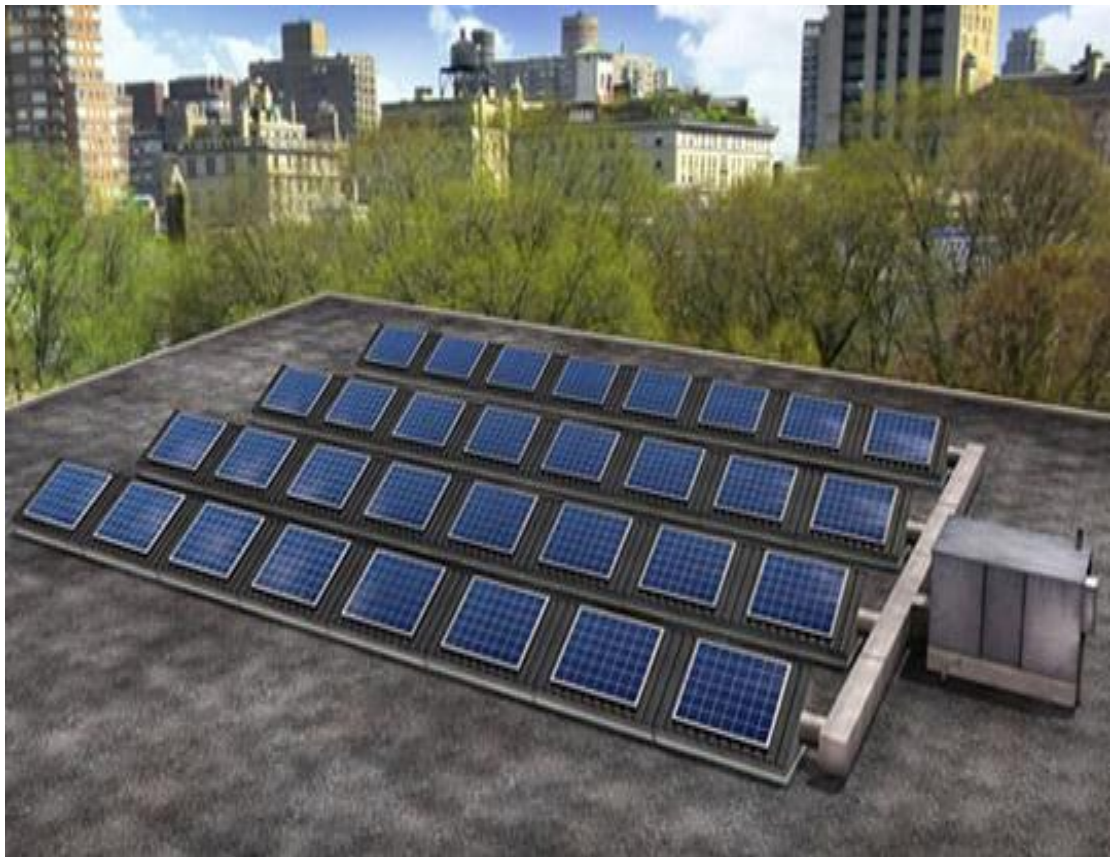
(Εικόνα 21) Εγκατάσταση PV/T με αέρα σε ταράτσα κτηρίου
