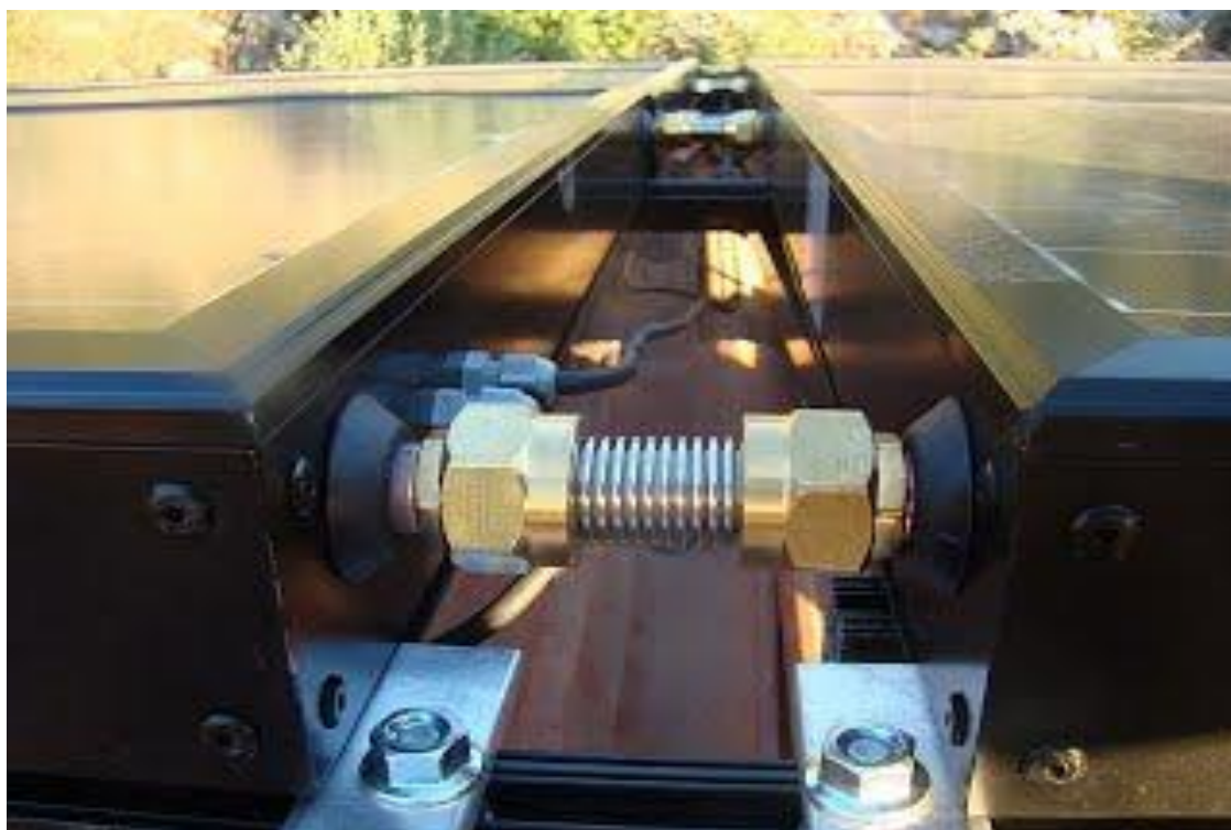
(Εικόνα 24) Εγκατάσταση PV/T με νερό σε σκεπή κτηρίου
