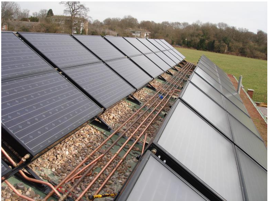
(Εικόνα 23) Εγκατάσταση PV/T με νερό σε σκεπή κτηρίου
