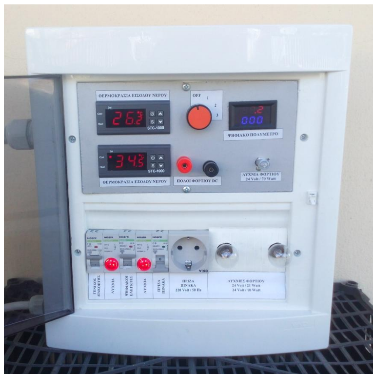
(Εικόνα 69) Πίνακας ελέγχου κατά την λειτουργία του
