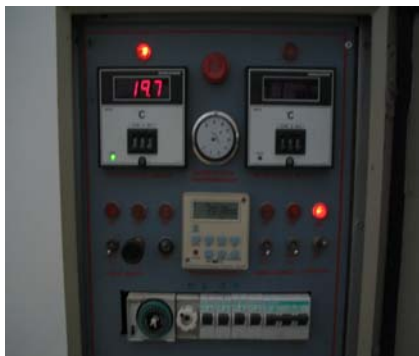
Εικόνα 5. Πίνακας ελέγχου, θαλάμου
