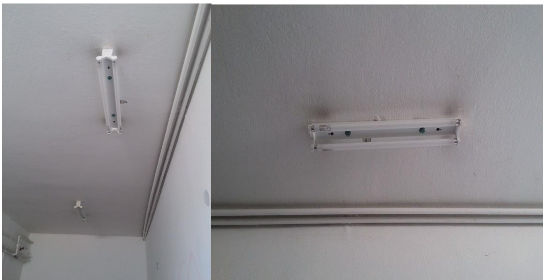
Εικόνα 36: Λαμπτήρες φθορισμού στις κοινόχρηστες τουαλέτες τις παλιάς ΣΤΕΦ
