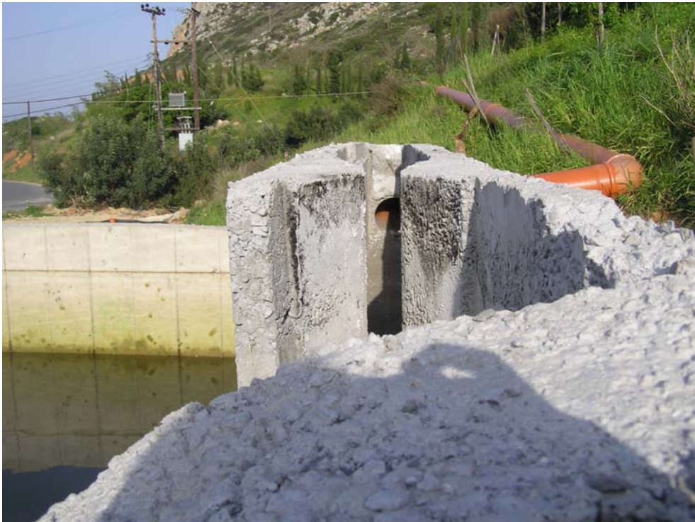
Φώτο 2.1 Ογκομετρητής υδάτων Parshal
