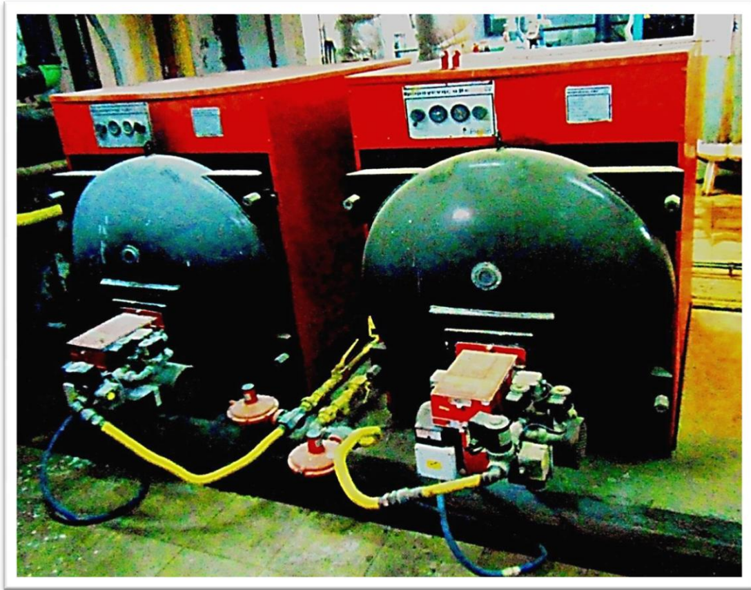
Εικόνα 34: Καυστήρες Υγραερίου στο κεντρικό μηχανοστάσιο
