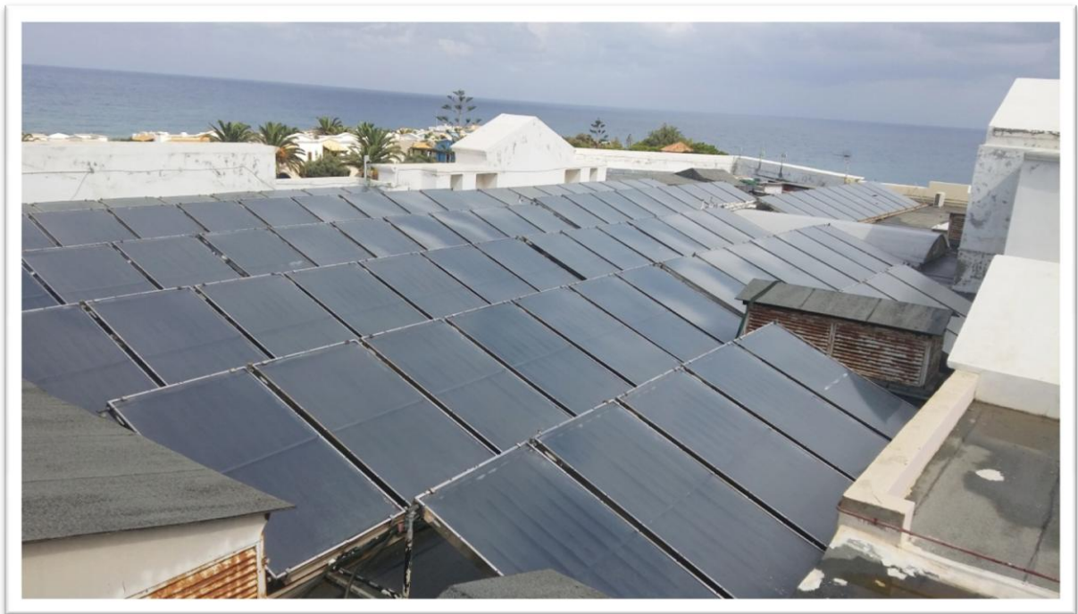
Εικόνα 11: Ηλιακοί συλλέκτες στο κεντρικό κτίριο
