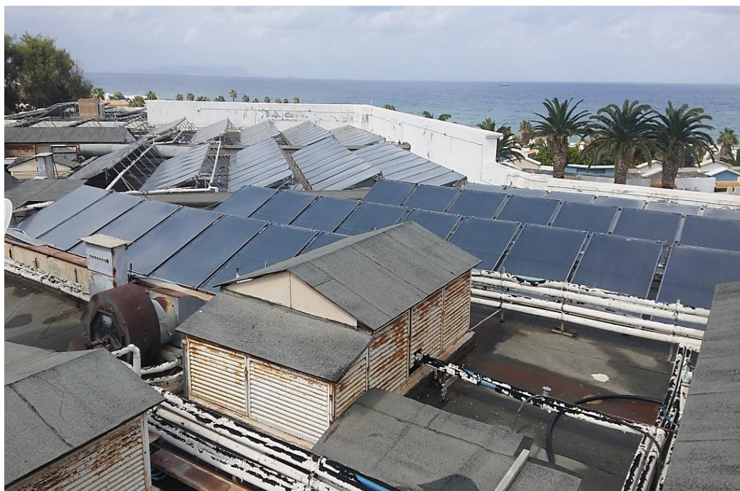
Εικόνα 21: Ηλιακά πεδία στο κεντρικό κτίριο
