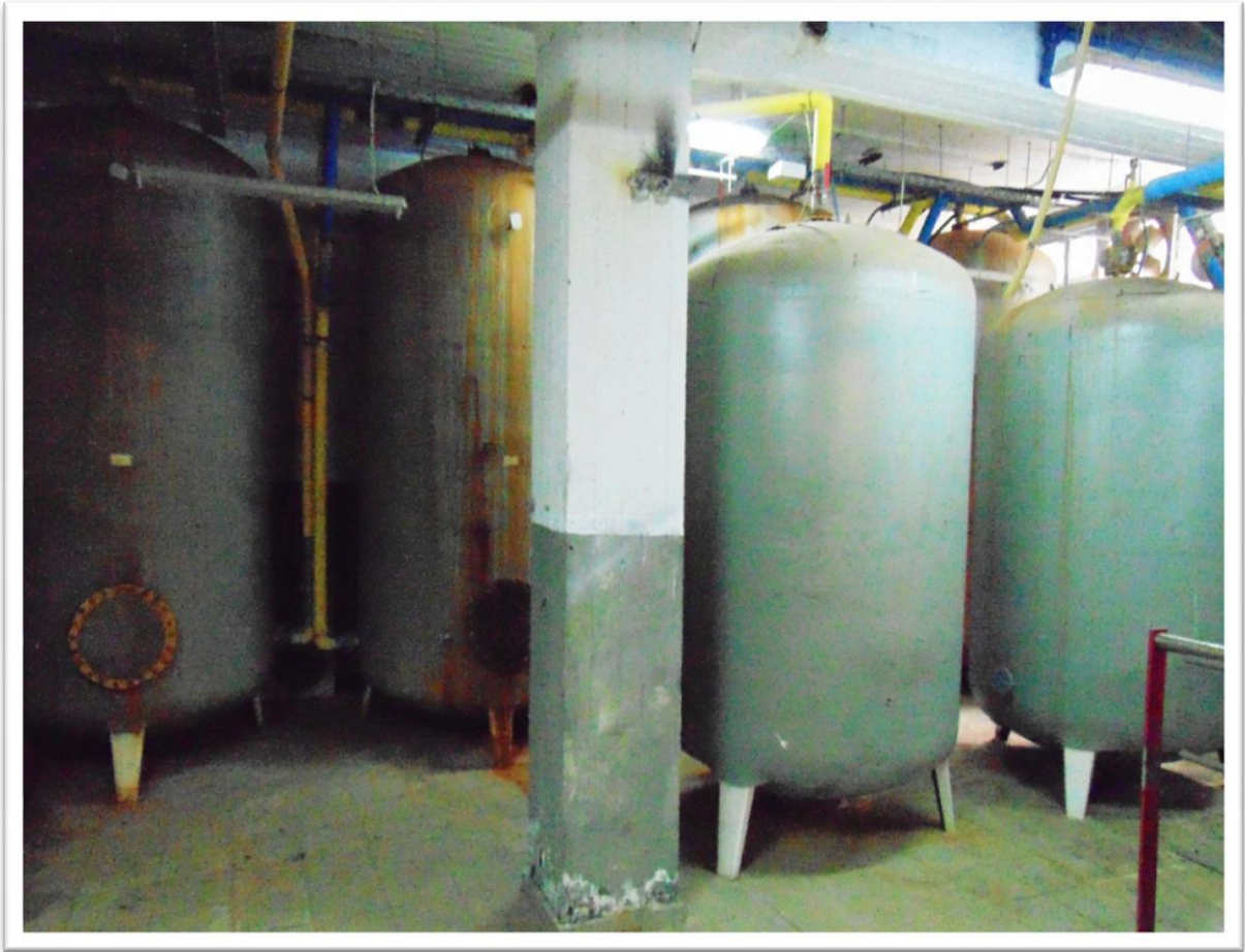
Εικόνα 33: Η συστοιχία των θερμοδοχείων-μπόιλερ νερού της εγκατάστασης στο κεντρικό μηχανοστάσιο
