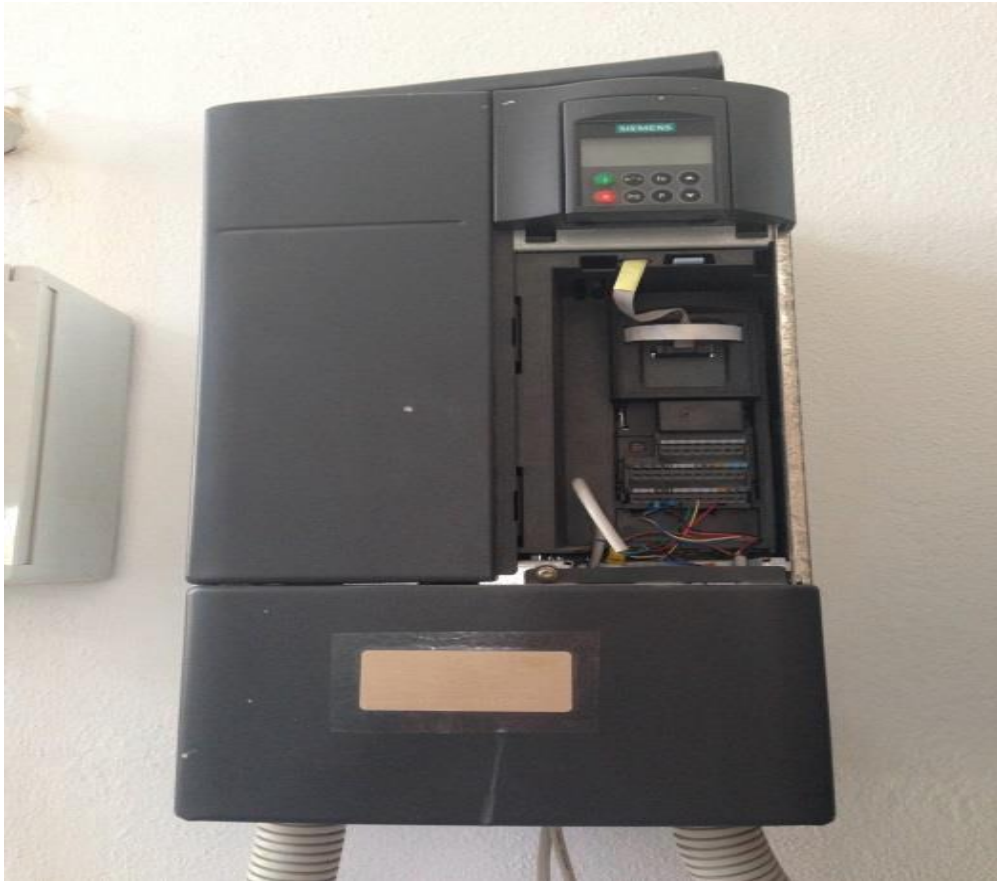
Εικόνα 19: Ο inverter του εργαστηρίου
