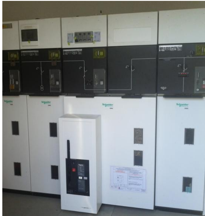
Εικόνα 4.2.4: Διακόπτης υψηλής τάσεως SF6 Merlin Gerin
