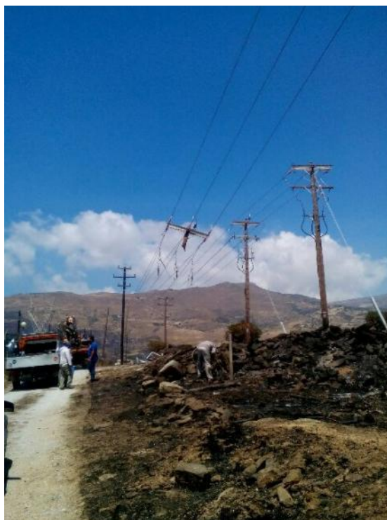
Εικόνα 4.3.3.: Πυρκαγιά στο δίκτυο
