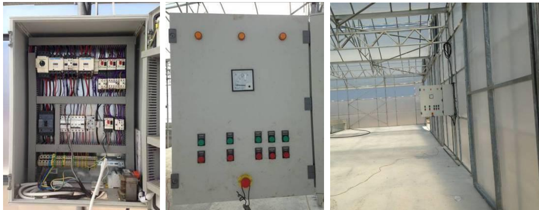
Ηλεκτρολογικός πίνακας μονάδας (εσωτερική, εξωτερική εικόνα πίνακα & τοποθέτηση αυτού στη μονάδα)
