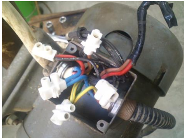
Εικόνα 30. Λύση και καταγραφή καλωδιώσεων κινητήρα.
